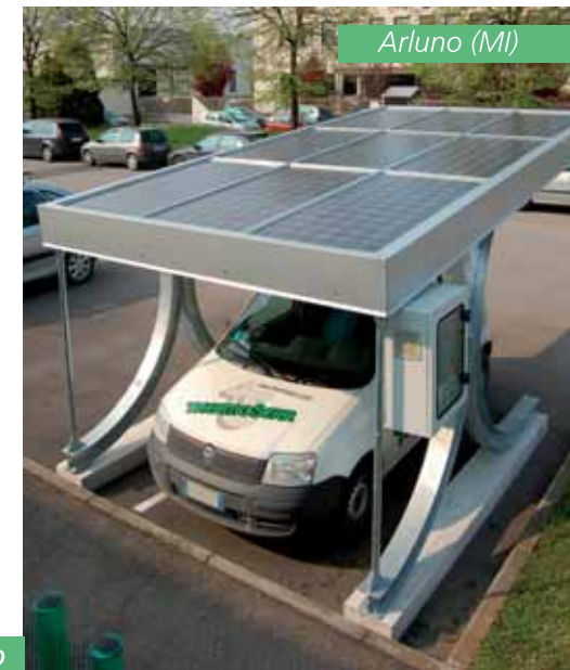
Impianto fotovoltaico da 1,8 kWp
